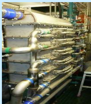
ガス冷却器 気仙沼地域エネルギー開発（株） (R2～)
