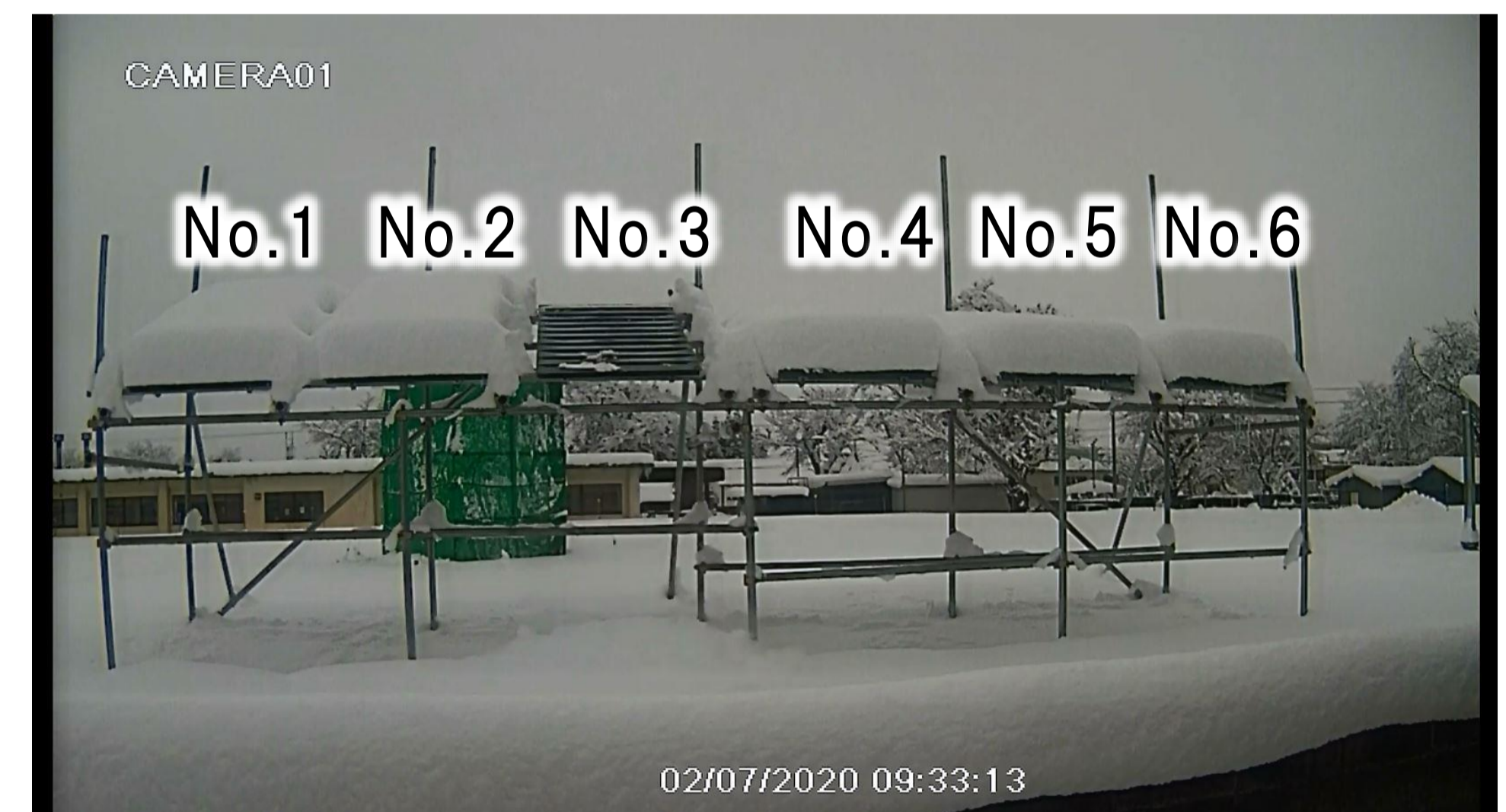
曝露試験の模擬屋根板設置状況(新庄市) No.1及び4:対照塗料①(二液フッ素塗料), No.2及び5:対照塗料②(一液シリコン塗料), No.3及び6:屋根用ワックス添加塗料。No.1~3は4寸勾配, No.4~6は2寸勾配。No.3が先行して落雪している。
